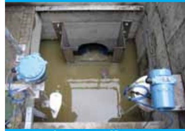
3100 and 3300 on effluent sump
